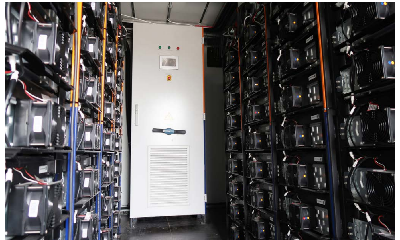
Inside a BESS
